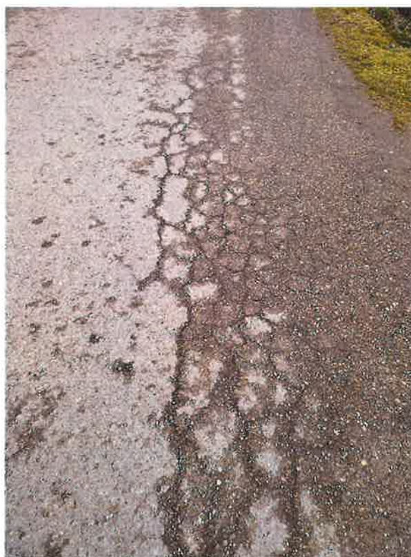
Foto 10. Strada 4 Bârsa – carosabil cu faianțări multiple și tasări de margine
