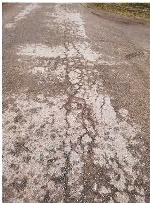
Foto 9. Strada 4 Bârsa – parte carosabilă cu fisuri și crăpături longitudinale
