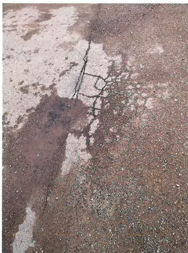
Foto 8. Strada 4 Bârsa – carosabil cu crăpături, groapă incipientă
