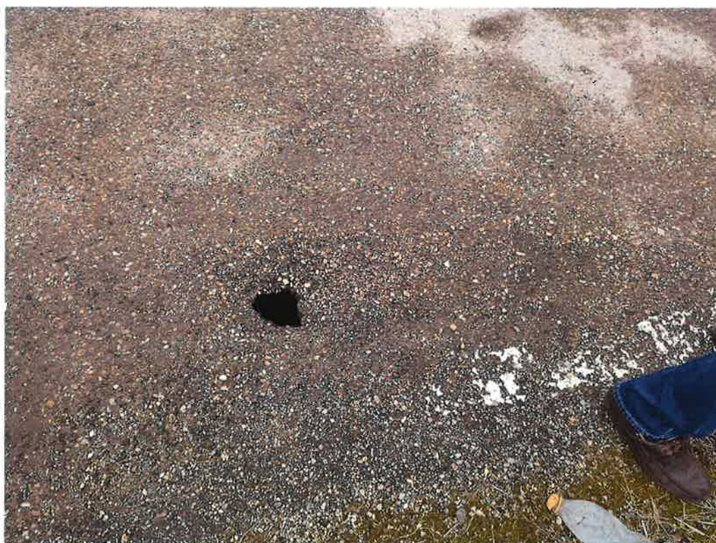
Foto 4. Strada 3 Bârsa – podeț dalat existent degradat, gaură în carosabil
