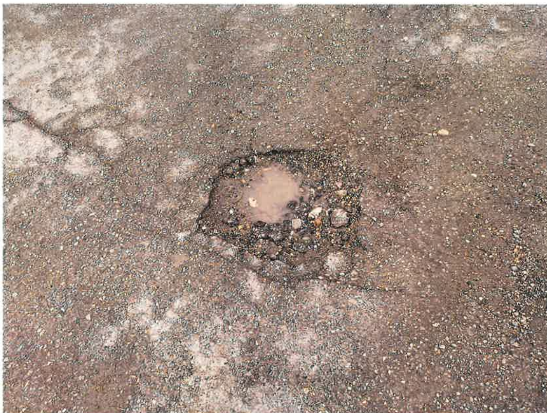
Foto 1. Strada 3 Aldești – carosabil cu gropi și crăpături
