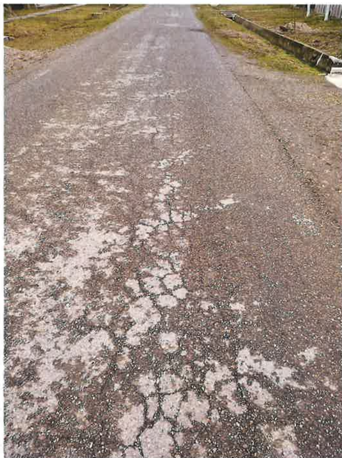
Foto 5. Strada 3 Bârsa – parte carosabilă cu faianțări
