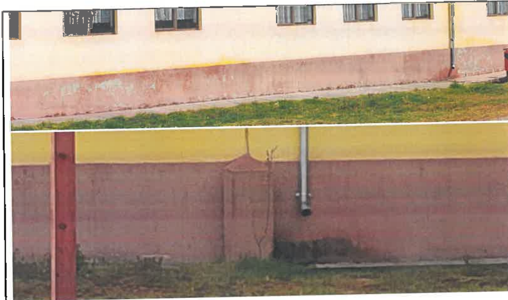
Fig. 2.b. Infiltrații de apă, tencuieli patate, exfoliate de pe stratul suport, zone umede localizate în zona soclului dotate sistemului deficitar de preluare a apelor pluviale
